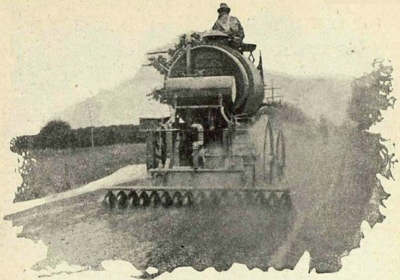
Пропитка грунтовой дороги маслом под давлением из конного гидронатора. Масло разливается равномерно и проникает в грунт
